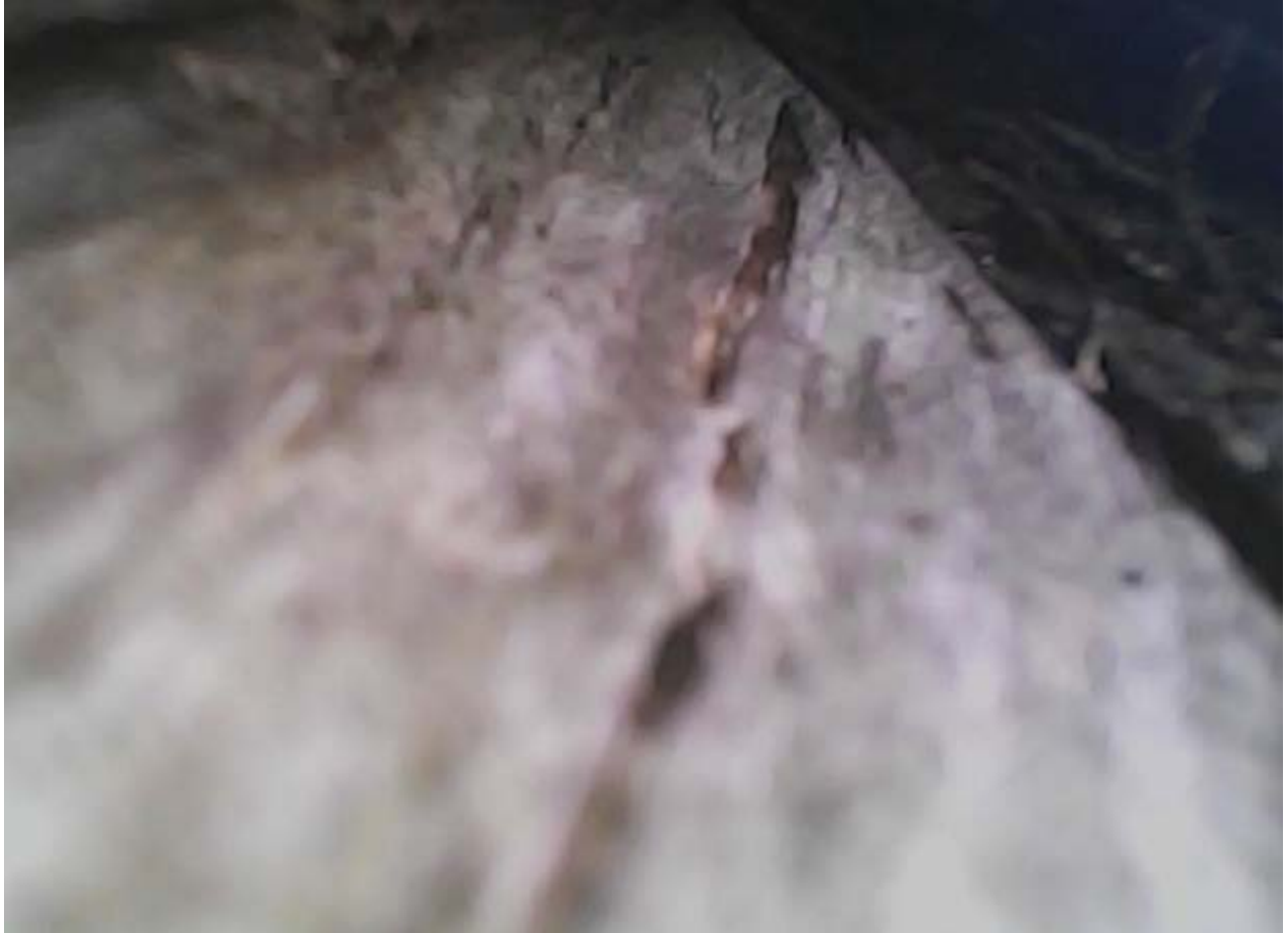
Abb. 9: Bild vom „Inneren“ einer beschädigten Holzverkleidung im Trauf-Bereich (Übergang vom Dach zum Mauerwerk), aufgenommen mit der Endoskop-Kamera
