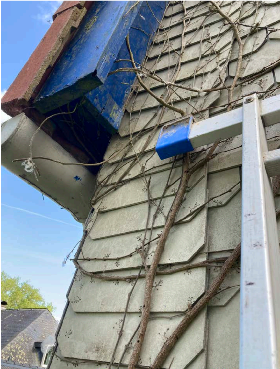
Abb. 7: Mit Hilfe einer Leiter und der Endoskop-Kamera konnten einige Hohlräume hinter der Verkleidung der Fassade eingesehen werden.
