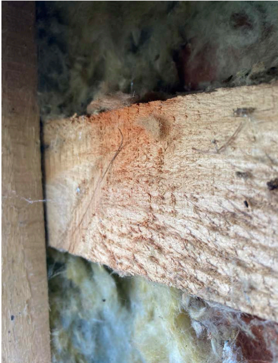
Abb. 8: Foto von einer beschädigten alten Holzverkleidung, hinter der, mit Hilfe der Endoskop-Kamera, nach Fledermausquartieren gesucht wurde
