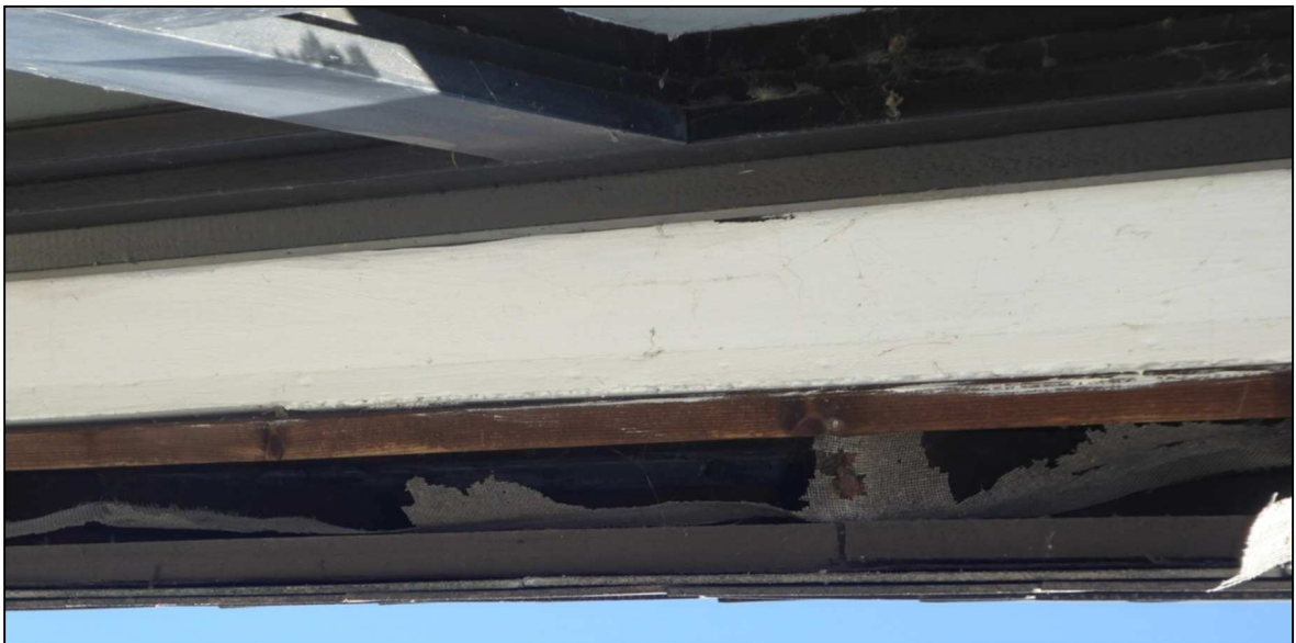
Abbildung 5: Blick in die Spalte der Fassadenverkleidung (20.09.2022)
